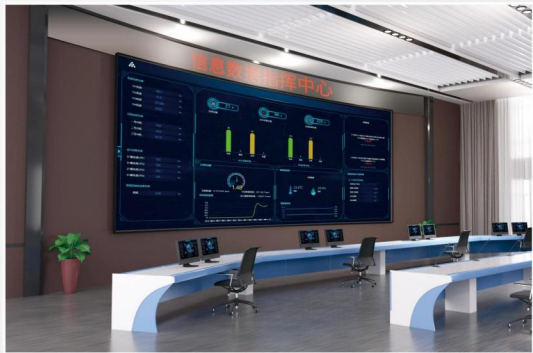
可视化数据中心
